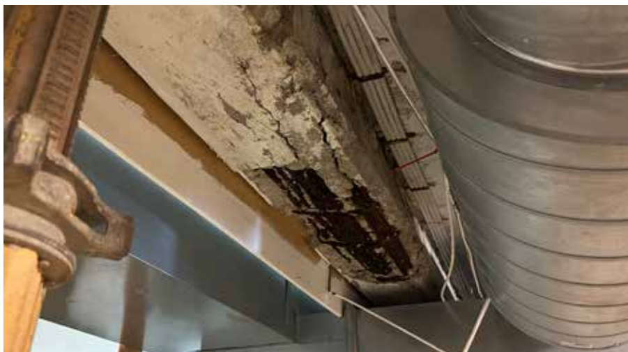
Garagebjälklagets undersida som visar rostig armering.
