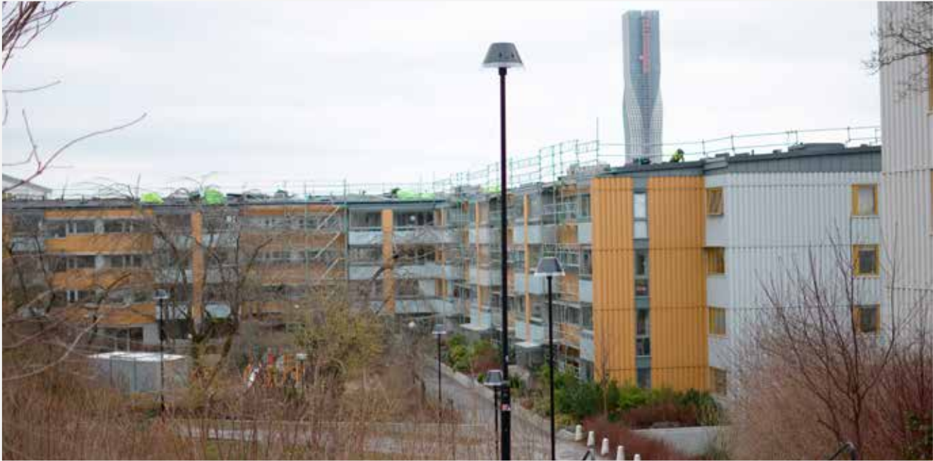
Här pågår takrenovering. Taken förstärks för att hålla för solceller. Karlatornet i närheten är en del av det nya Göteborg.
