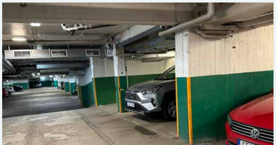
Det var när hyresgästen under garaget började klaga på vattendropp som man förstod att det var hög tid för en renovering.
