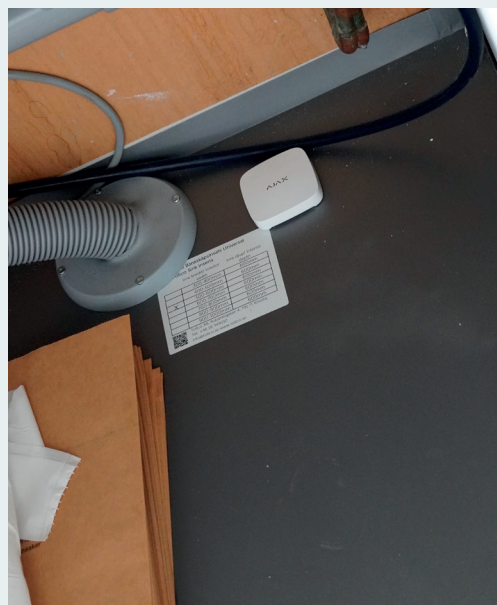
Systemets dosor för att spåra fukt läggs bland annat under diskbänkarna i lägenheterna.
