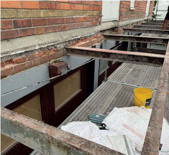
Balkongrenovering i Bromma efter att betongkonstruktionen varit skadad.
