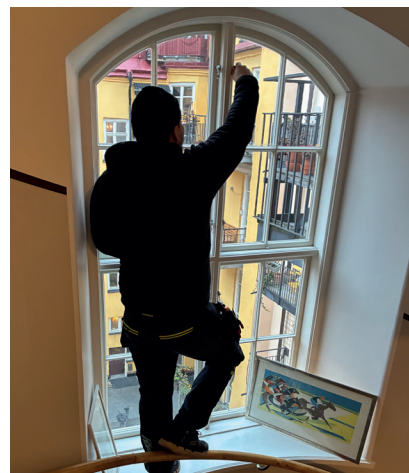
I jobbet som fastighetsskötare gäller det att vara beredd på det mesta.
